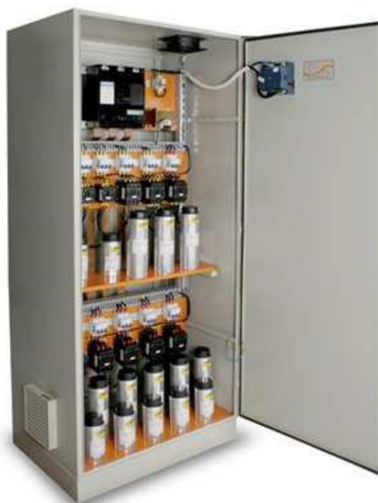
Fig. 51 – quadro de capacitores
