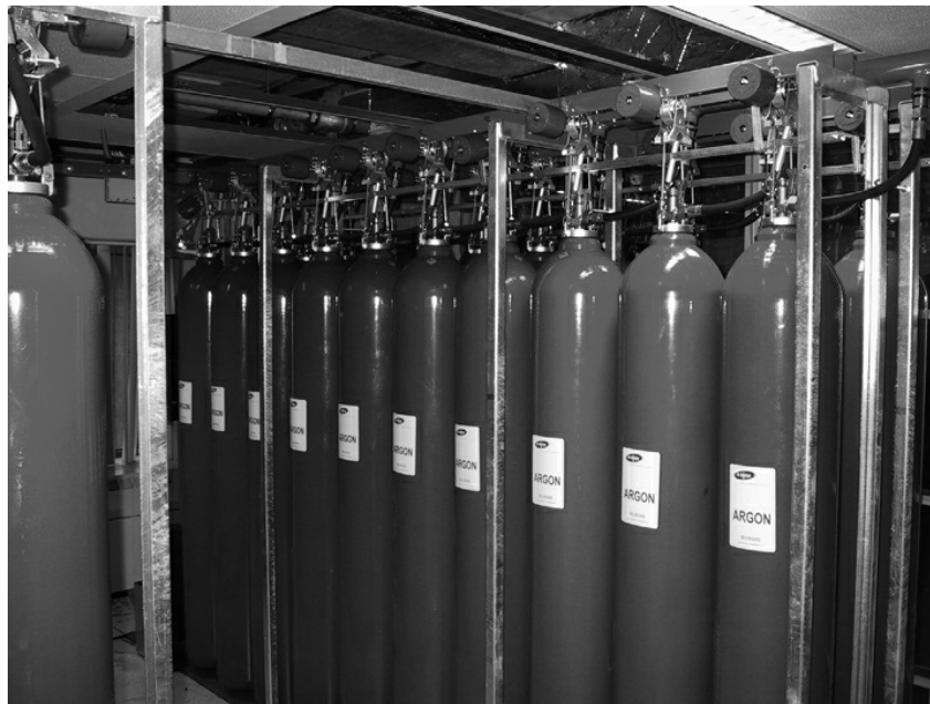
Figura 11.2. Exemplos de equipamentos de extinção de incêndio encontrados em uma sala de servidores.
